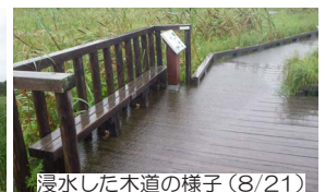
浸水した木道の様子(8/21)
